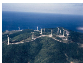
275kW×5, 300kW×5 500kW×1 電飛岬 NEDO/東北電力 1992年
