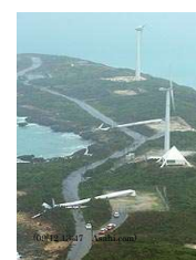
宮古島の風車被害 台風14号, 2003年
