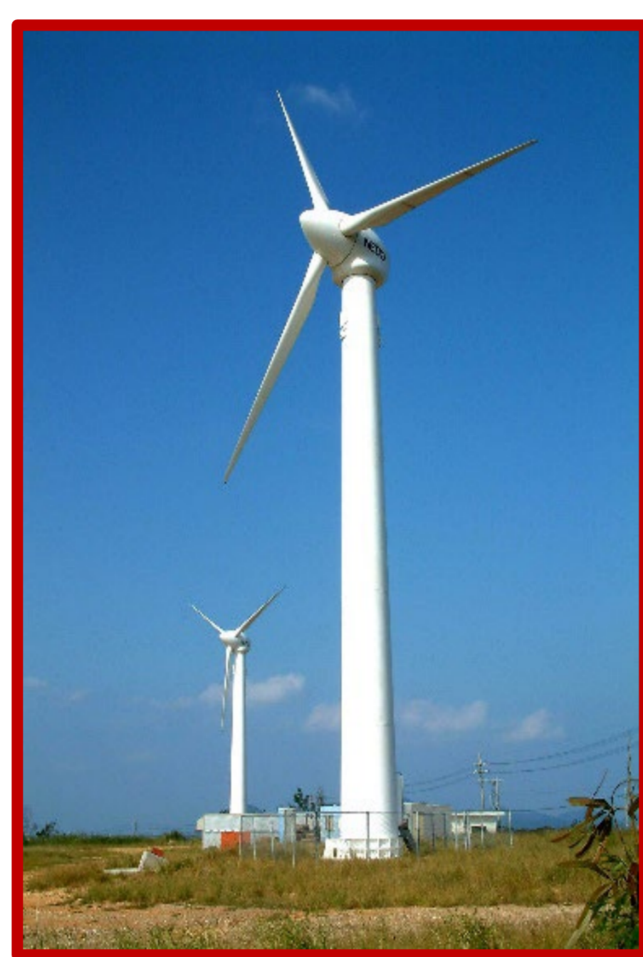
NEDO離島風車 100kW 量産
